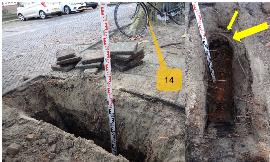
Foto 8: Links: profielsleuf 4 (P4) bij boomnummer 14, 2,8 m uit de stamvoet aan de westzijde. Rechts: detailfoto P4, gele pijl geeft de aangetroffen laagspanning kabels aan. De oranje rode verkleuring op de bodem van de profielsleuf is de aangetroffen puinlaag.
