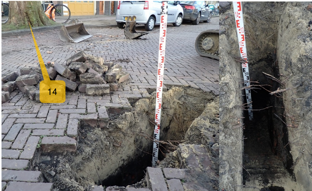
Foto 10: Links: profielsleuf 5 (P5) bij boomnummer 14, 8,0 meter uit de kademuur, op de grens van de nieuw te bouwen geven. Rechts detailfoto van P5.
